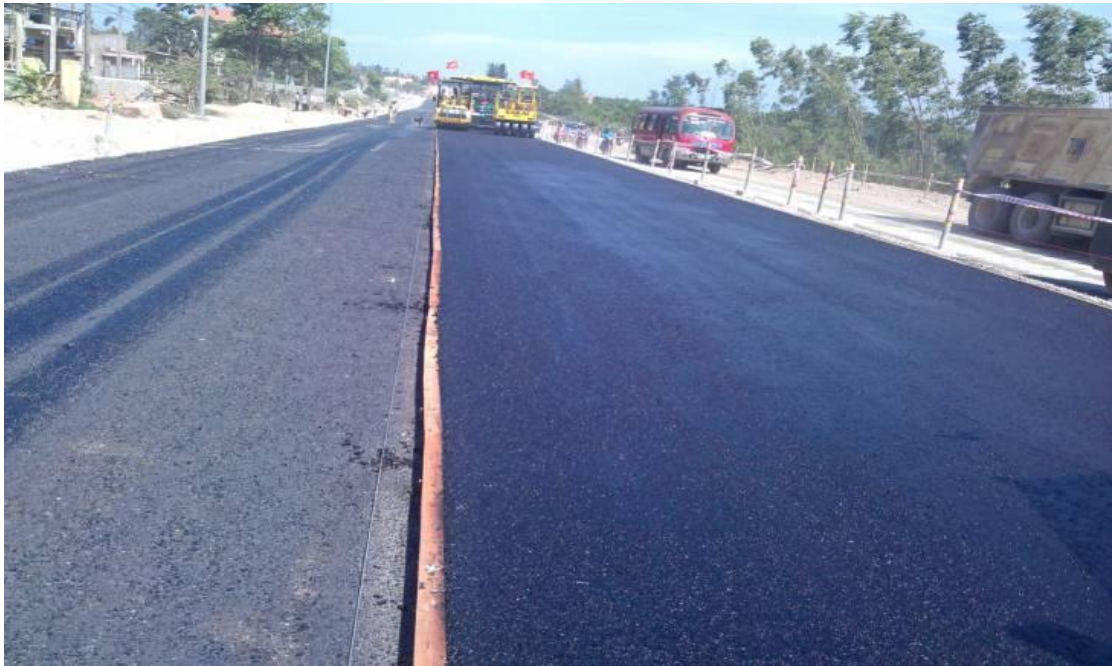
Thi công mặt đường bê tông nhựa hạt trung C19 Dự án nâng cấp mở rộng QL1 đoạn qua tỉnh Quảng Bình
