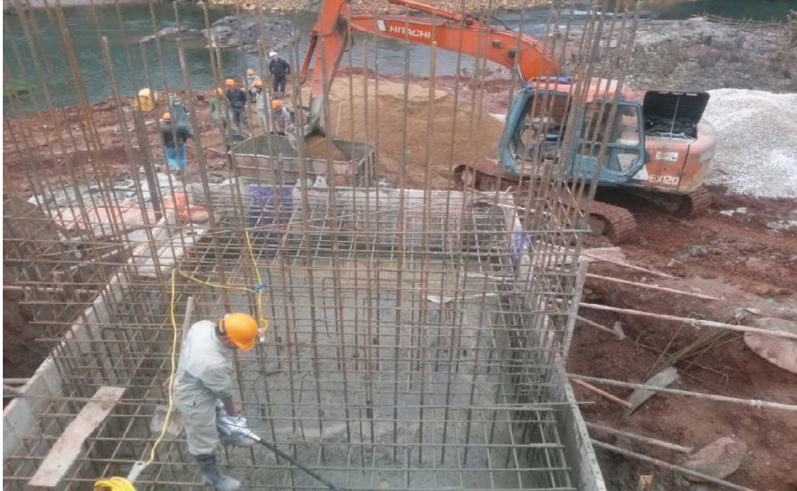
Đổ bê tông móng trụ tháp cầu K-reeng, xã Dân Hóa, huyện Minh Hóa. Dự án 186 Cầu treo dân sinh
