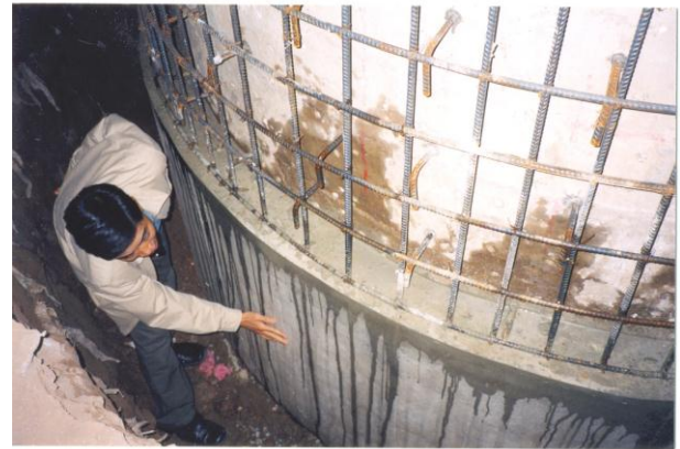
Ứng dụng Bê tông tự đầm trong thi công cầu Chương Dương
