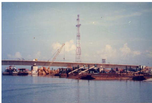
Cầu Sông Gianh, Quốc lộ 1A – tỉnh Quảng Bình sử dụng phụ gia chống xâm thực môi trường biển Zecagi-XB
