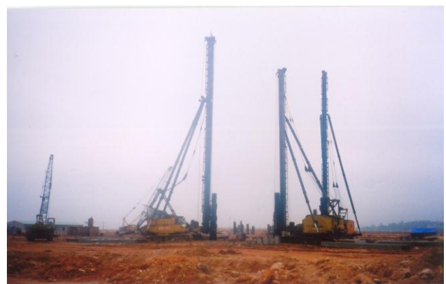
Nhà máy xi măng Thăng Long - Hoàng Bồ – tỉnh Quảng Ninh sử dụng phụ gia chống xâm thực môi trường biển Zecagi-XB cho hạng mục móng
