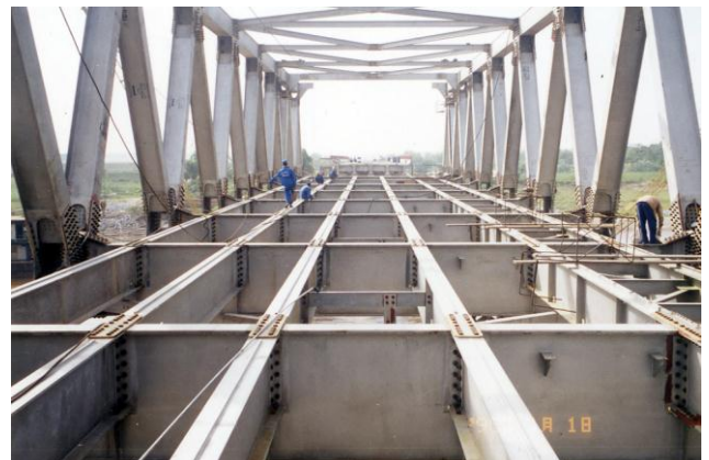
Bảo vệ dầm thép cầu Hồ - Bắc Ninh bằng hệ sơn epoxy và cao su clo hóa năm 2001
